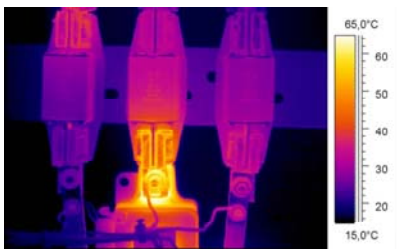
Podłączenie przekładnika prądowego.
