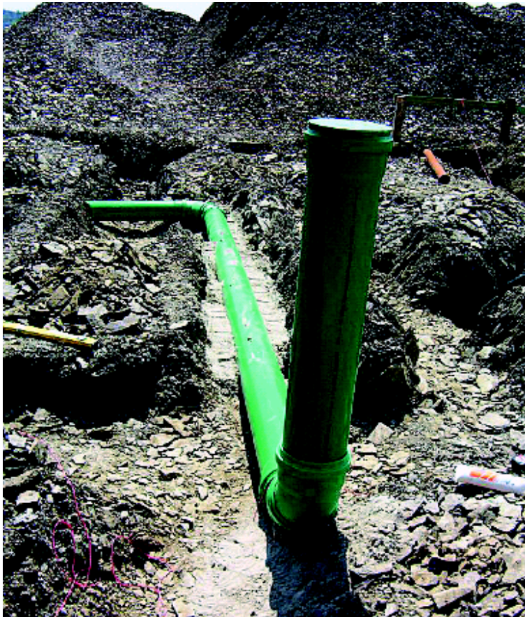
Gruntowy wymiennik ciepła wykonany z kształtek do wykonywania instalacji kanalizacyjnych
