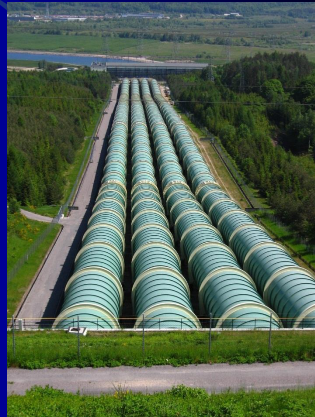
Elektrownia Szczytowo-Pompowa w Żarnowcu - rury, którymi spływa woda ze zbiornika Czymanowo (sztuczne jezioro powierzchni 122 ha i pojemności 13 milionów metrów sześciennych)
